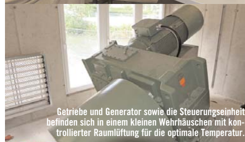
Der Leiter des E-Werks Kindberg DI Martin Weitzer kann die neue Wasserkraftschnecke von der Leitwarte aus vollständig fernwarten.
