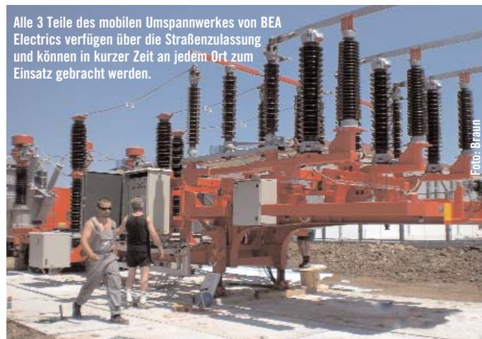
Der Umspannertrailer mit 13,5 Metern Länge, 2,55 Metern Breite und circa 55 Tonnen Eigengewicht ist das größte der 3 Fahrzeuge des mobilen Umspannwerks von BEA Electrics.
